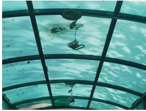
16、翠湖小区 156 号楼 2 单元楼道问题
