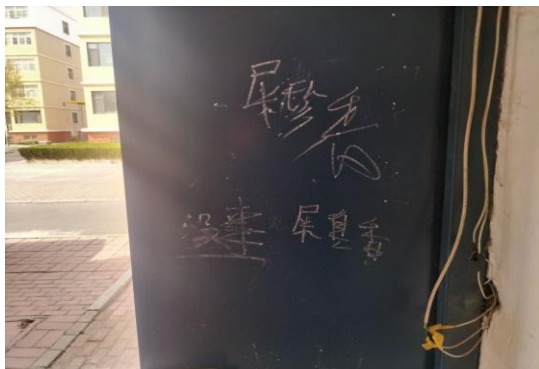
19、碧水苑小区 36 号楼 3 单元楼道问题
