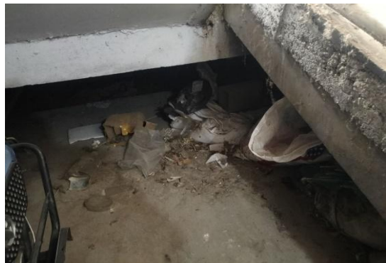
18、碧水苑小区 36 号楼 3 单元楼道问题
