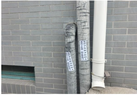
15、翠湖小区 168 号楼室外问题
