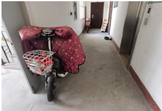
17、翠湖小区 156 号楼 2 单元楼道问题
