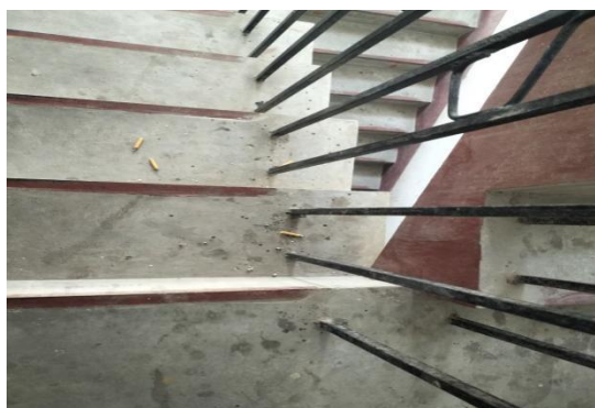
5、翠湖小区 168 号楼 2 单元楼道问题
