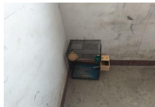
6、翠湖小区 168 号楼 2 单元楼道问题
