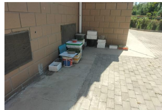
4、科苑小区 1 号楼室外问题
