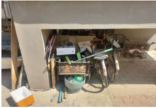
13 科苑小区 14 号楼室外问题
