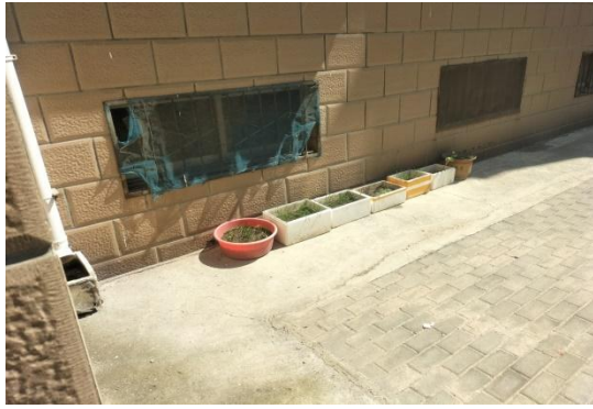
7、科苑小区 2 号楼室外问题
