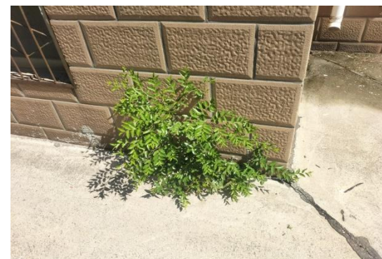
6、科苑小区 2 号楼室外问题
